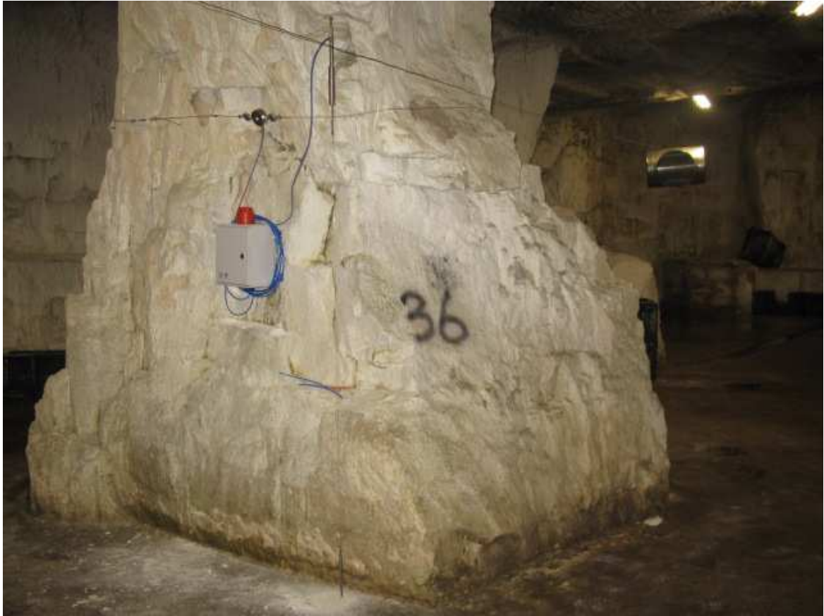
Centralina con allarme – Cella di Carico ed Estensimetro verticale su pilastro
